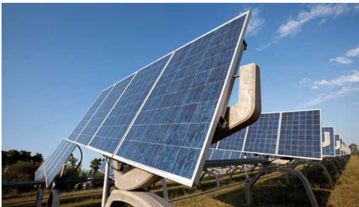
Installation photovoltaïque équipée de suiveurs
